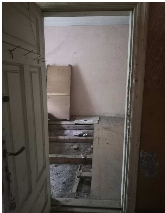
37 ilustr. widoczne ubytki w drewnianej podłodze
