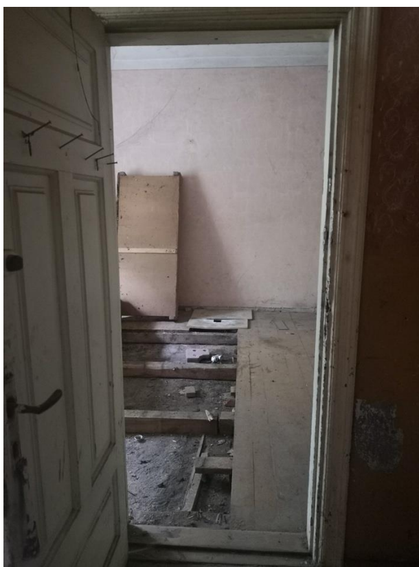
widoczne ubytki w drewnianej podłodze
